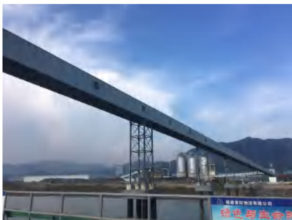
封闭式皮带输送机
