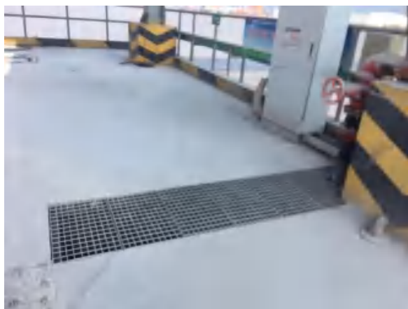
5#泊位码头平台上的初期雨水收集池
