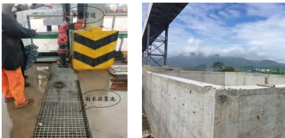
码头平台上的初期雨水收集池
